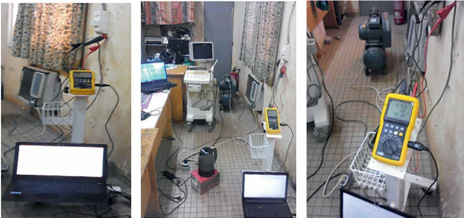
Figure 5. Mesure des harmoniques électriques générés par les appareils monophasés.
